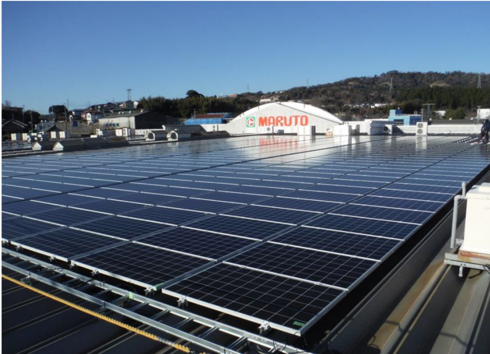
写真:SC滑川店の太陽光発電システム
